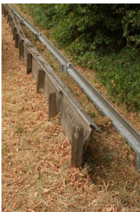
Maroder Holzzaun und stabile Leitplanken 2018
